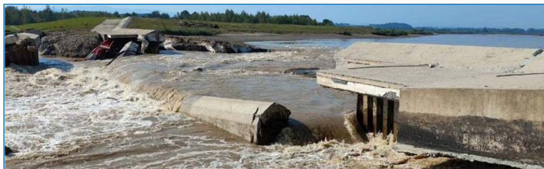
Zdjęcie 5. Zniszczony przelew powierzchniowy boczny zbiornika Topola na rzece Nysie Kłodzkiej [Źródło: PGW WP RZGW we Wrocławiu]
